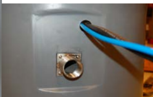
Kablarna från pump och kabel/slang från
